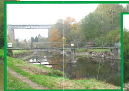
Automne 2010 : Abaissement du clapet de Rochette
