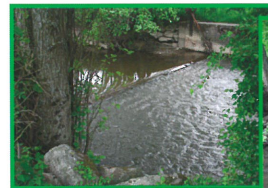
Printemps 2006 : Abaissement du clapet
